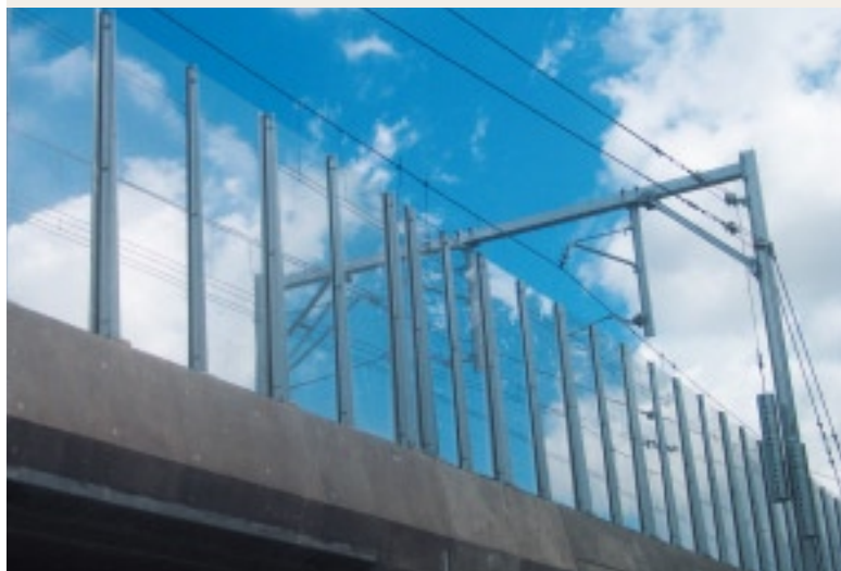
Шумозащитная стена Parramatta Rail Link, Sydney
